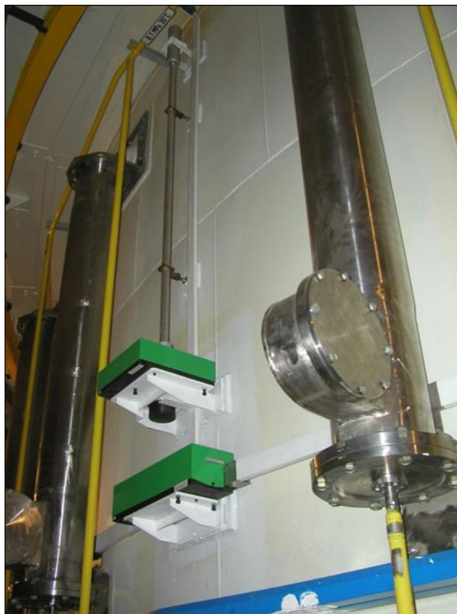
Obr. 1.: Umiestnenie snímačov Nivelomat a Vertimat meracieho systému ÚM SAV, v.v.i. na vonkajšej strane reaktorovej nádoby 4. bloku jadrovej elektrárne Mochovce
