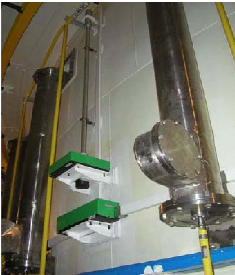
Umiestnenie snímačov meracieho systému na šachte reaktora
